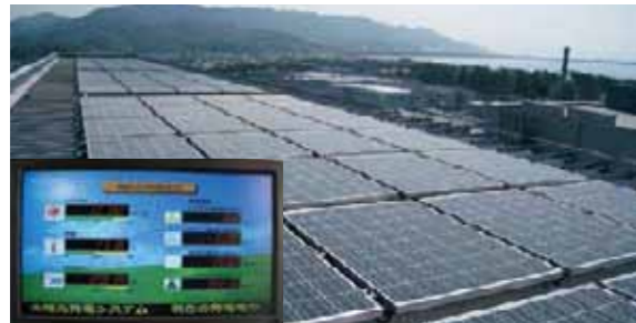
太陽光パネル Solar panels
