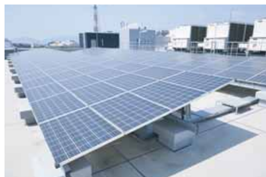
光工場の太陽光発電設備
